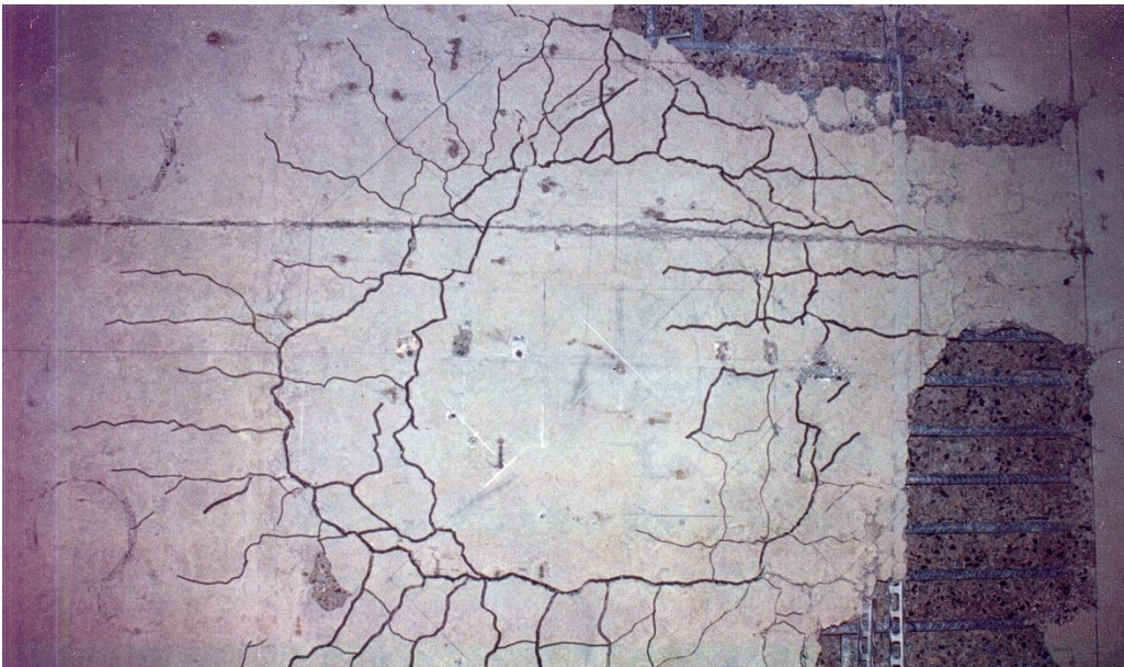
Bild 4.1: Rissverlauf des Versuchskörpers A
