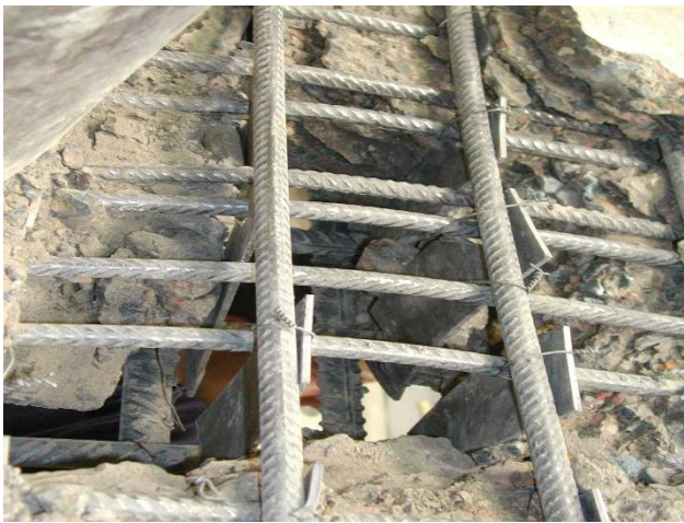
Bild 4.17.1: Einbauteile im Stützenbereich
