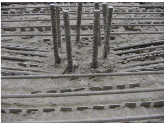
Bild 4.20.3: Durchbiegung der Fangnetzbewehrung und der Einbauteile
