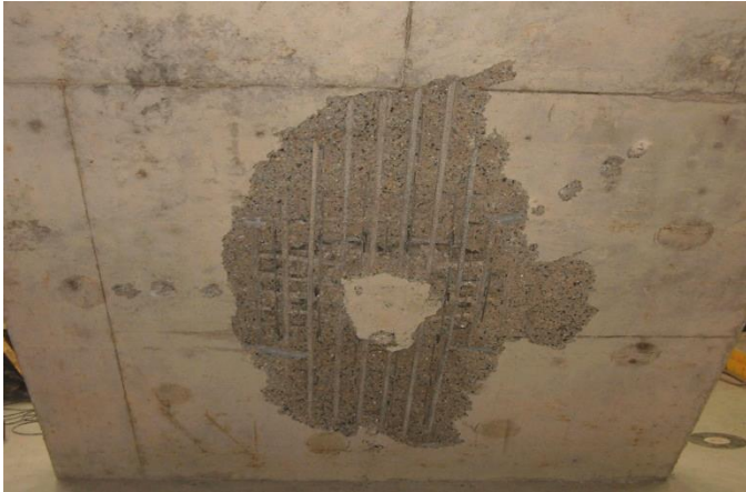
Bild 4.7.1: Risse und Abplatzungen der Betondeckung
