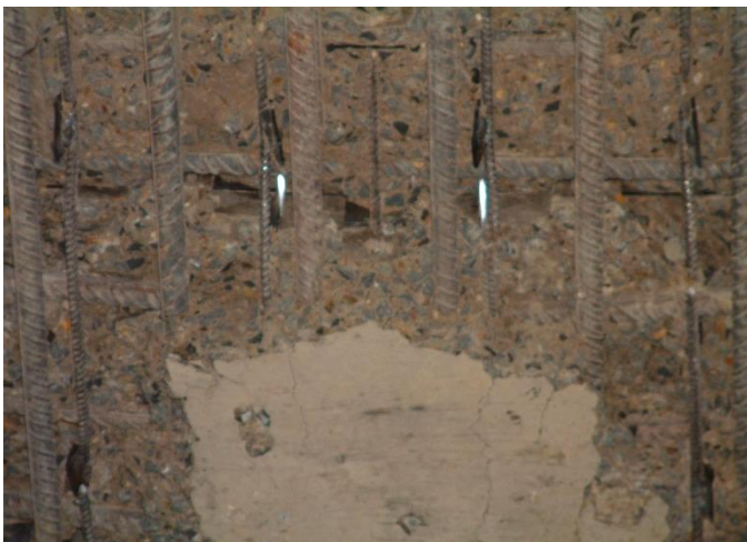
Bild 4.7.2: Deutliche Verformung der Umfassungsbewehrung
