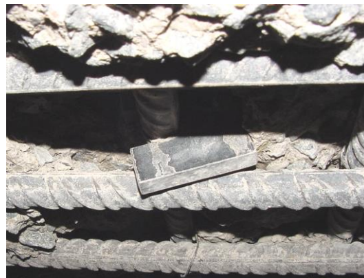
Bild 4.11.3: Durchbiegung der Bewehrung am Stützen-Rand
