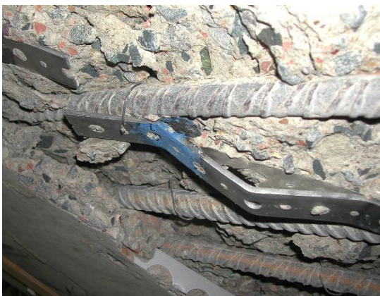
Bild 4.15.2: Einbauteile im Stützenbereich
