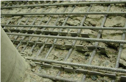
Bild 4.16.2: Unverformte Einbauteile im Stützenbereich
