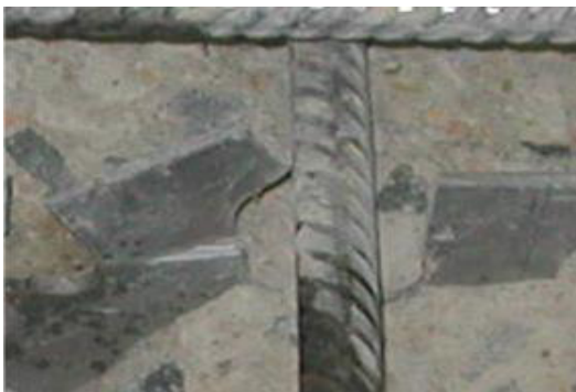
Bild 4.18.2: Verformtes Einbauteil im Riss
