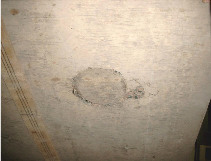
Bild 4.12.1: Versagen im Belastungsbereich
