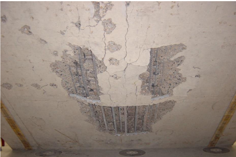
Bild 4.9.1: Durchstanzbereich mit Risse in Richtung der zur Umschnürung der Bewehrung vorgesehenen Einbauteile
