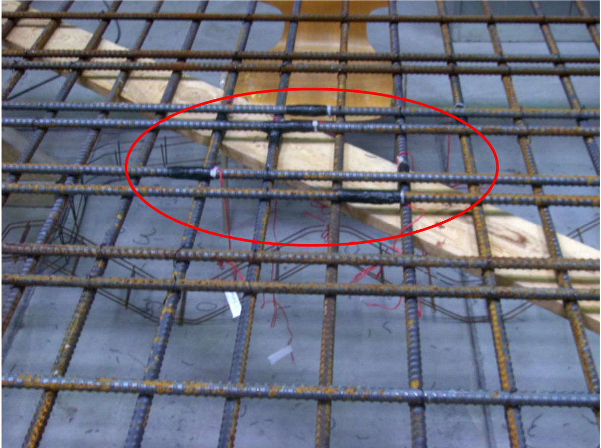
Einbaulage der DMS auf dem Spann Stahl
