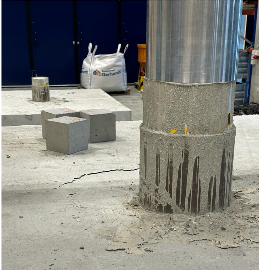
Rissverlauf um Stütze
