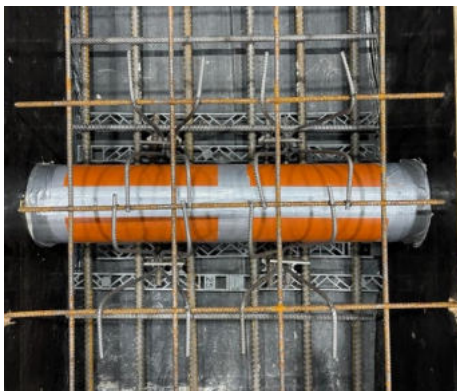
Die obere Bewehrung wurde in 2cm tiefe Schlitz in der Schalung eingelegt.
