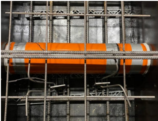
Fixierung der oberen Bewehrung mit Ø12 auf der Schalung. Entfernung nach dem Betonieren.
